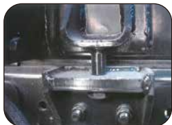
締結ボルト折損
