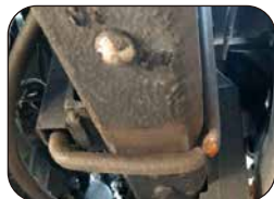
Uボルト折損
