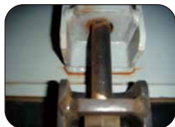
溶接ブラケット亀裂
