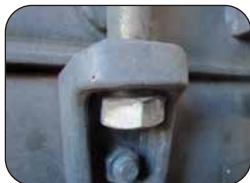
締結ボルト緩み・伸び
