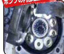
ポンプの内部破損...
