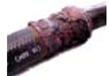
■ 継ぎ手部発錆
