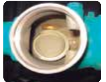
※シャフト摩耗折損、弁体脱落
