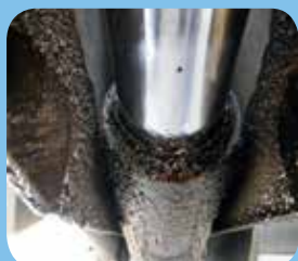
シリンダ油漏れ・メッキ剥離
