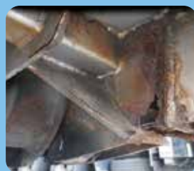
プラットホーム腐食
