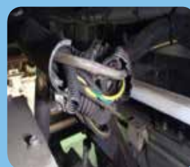
配線かみ込み断線
