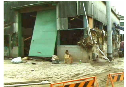
洪水流で破壊された工場
