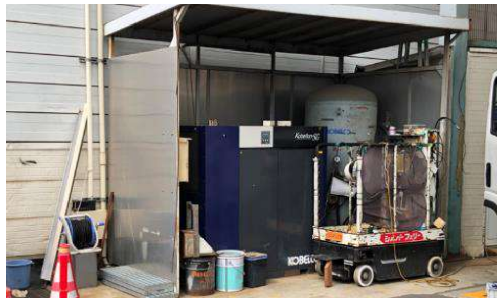
エアコンプレッサー（各建屋に配管で供給）
